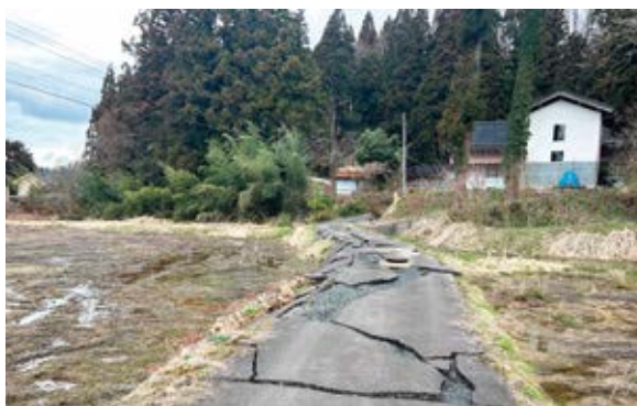
亀裂しマンホールが浮き上がっている農道
