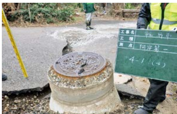
隆起しているマンホール
